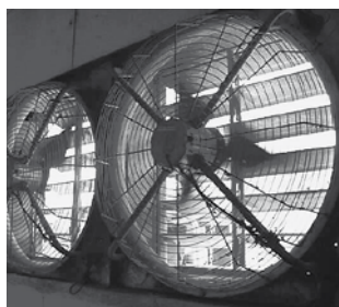
写真2 安全を確認してから換気扇の掃除も忘れずに!
