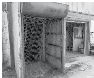
写真3 入気側を大きく開放した事例（防鳥ネットも設置）
