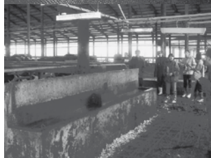
写真5 ヒーターを吊るして水槽周辺の凍結を防止している事例
