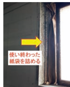
写真2 風雪の強い日でも、窓は開けたままにしておき、使い終わった紙袋を窓の開いた部分に詰め込んで工夫している事例があります（写真2）
